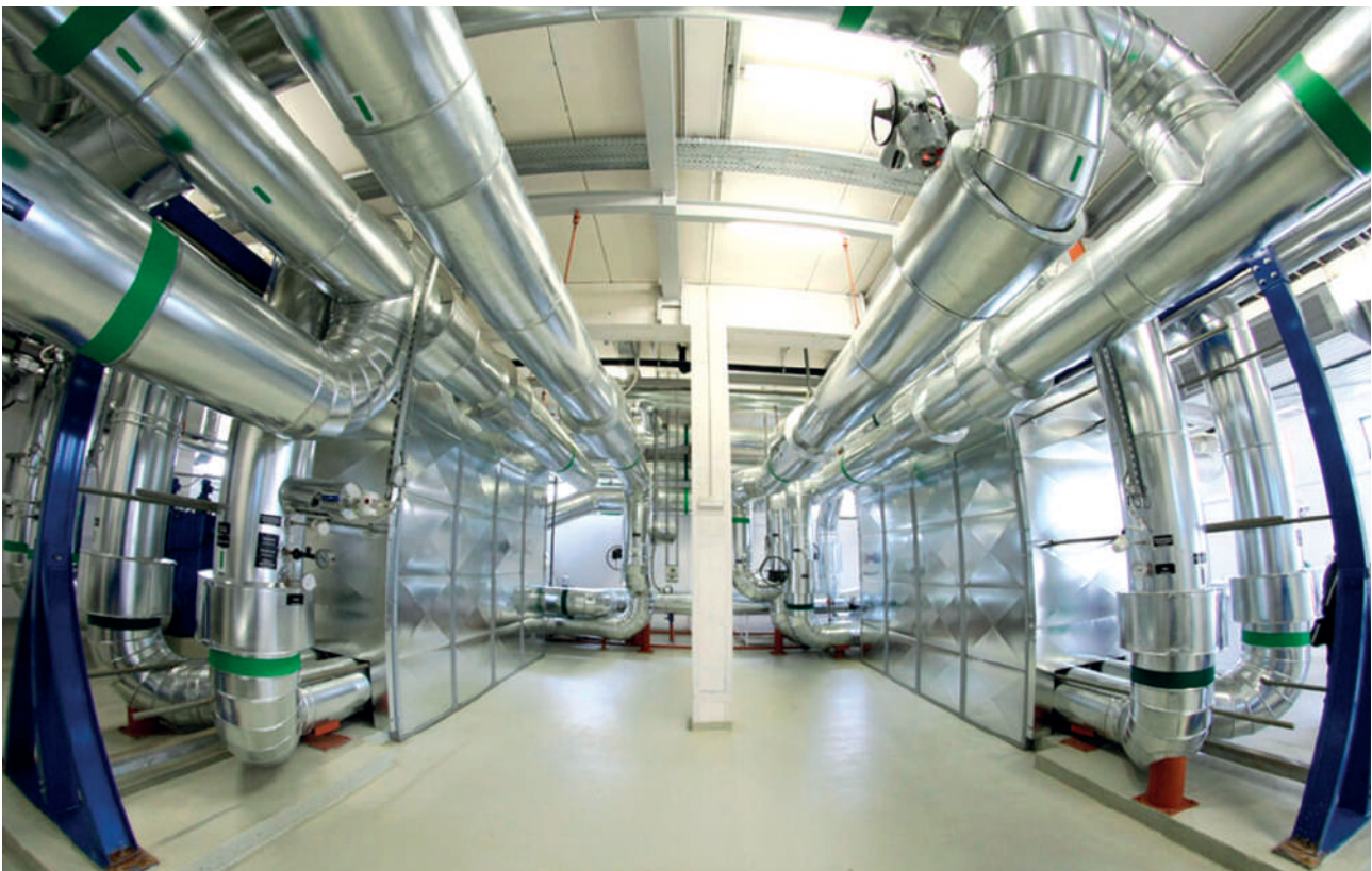
Geotermalno postrojenje Miškolc u Mađarskoj (izvor PannErgy)
